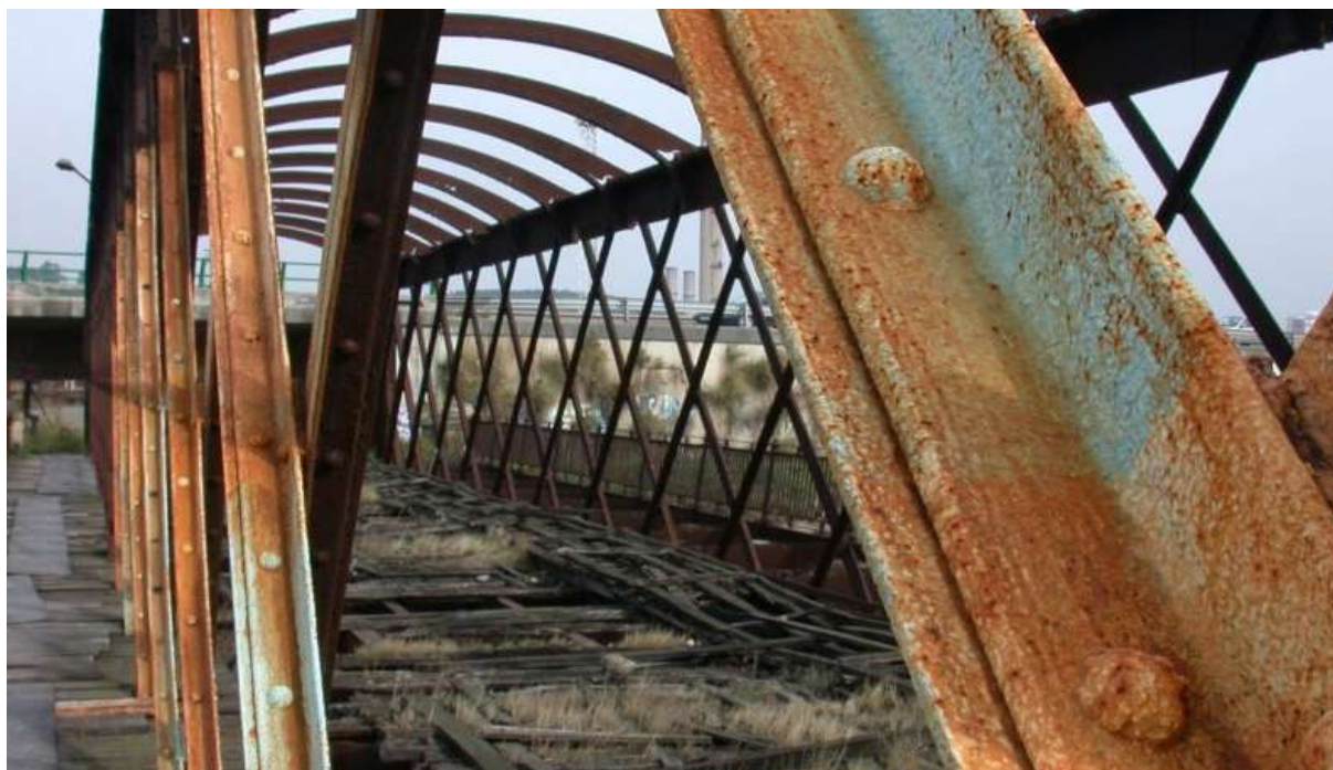
Figura 7.1.1 - Imagem exemplo de deterioração de peças estruturais metálicas
