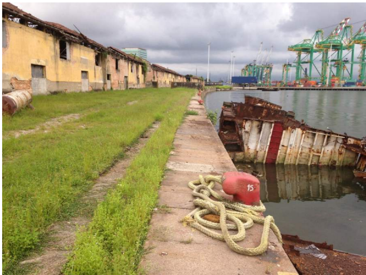
Figura 5.5: Armazéns tomabados e degradados na Hintertlândia. Fonte: Disponível em: < https://linhametalica.wordpress.com/2016/04/05/porto-de-santos-galpoes-do-valongo/#jp-carousel-167 >. Acesso em: 17/05/2021.
