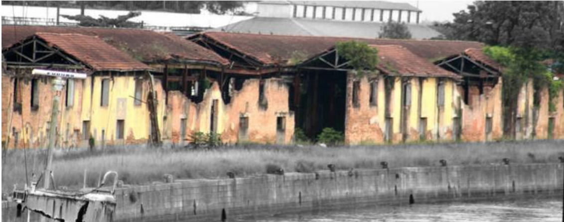
Figura 10: Armazéns degradados na orla portuária do Valongo.
